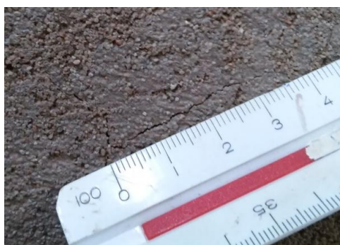
Figura 10 - Fissura na argamassa 30%CF com 1dia
