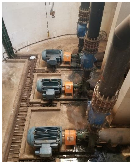
Figura 2: Conjunto moto-bomba da unidade Elevatória de Esgoto de Águas Claras- DF
