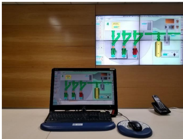
Figura 4: Centro de Controle Operacional da CAESB.
