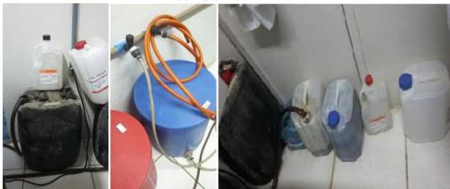
Figura 2. Armazenamento interno dos produtos químicos utilizados no processo de revelação de Raio-X.
