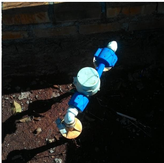
Figura 12 – Medidor individual de abastecimento de água
