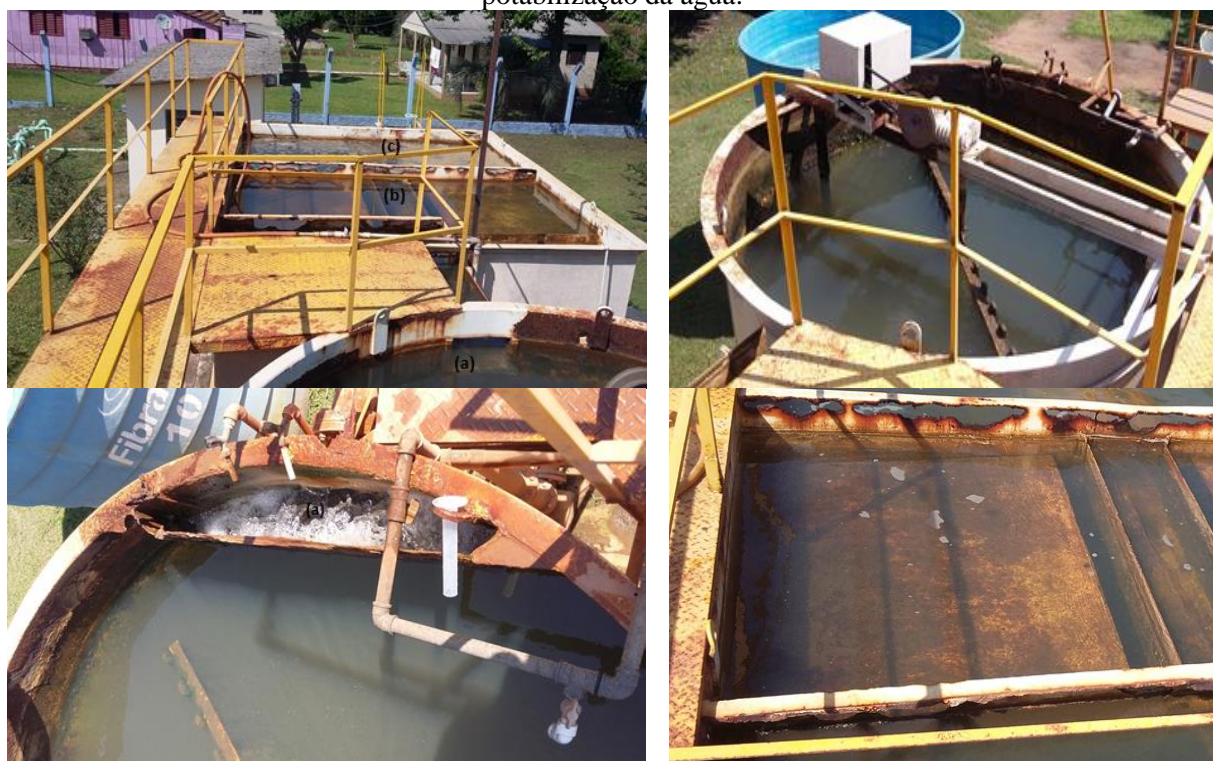
Figura 1 – Vista da parte superior da ETA semi-compacta com Tratamento Convencional para a potabilização da água.
