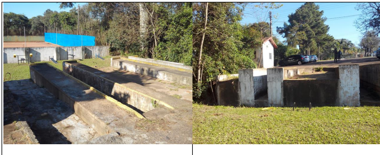
Figuras 5 e 6 - Rampa de lavagem inadequada, sem possui sistema de coleta e tratamento do efluente. Fonte: Autor
