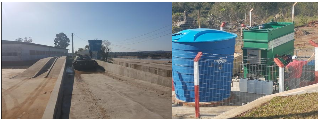
Figuras 1 e 2 - Rampa de lavagem adequada com sistema de tratamento de efluentes. Fonte: Autor
