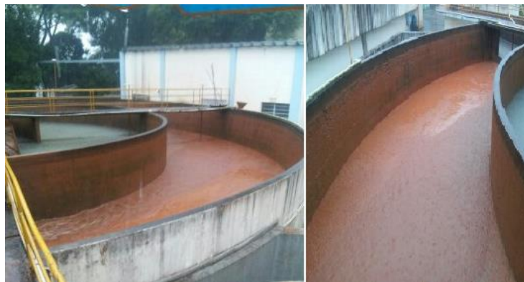
Figura 1 – Decantador com resíduo de lodo
